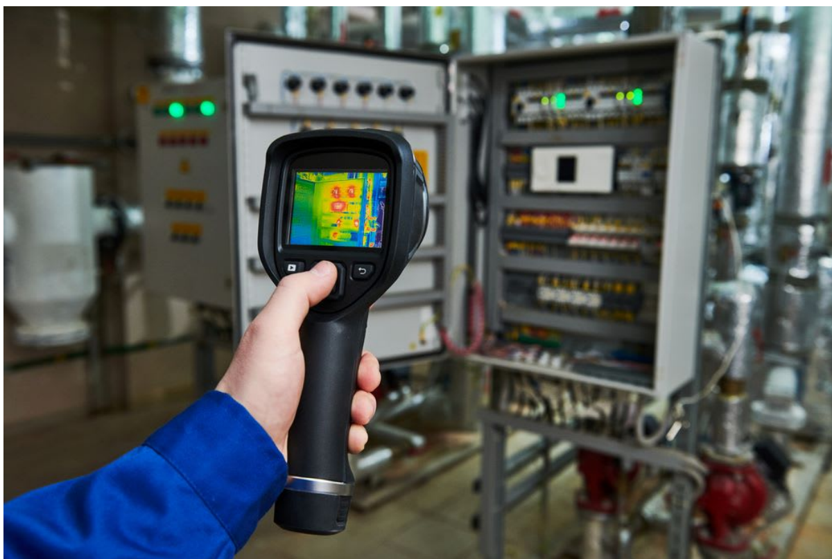
ภาพประกอบที่ 5.1-2: การตรวจสอบตู้ไฟฟ้าด้วยกล้องถ่ายภาพความร้อน (Thermal Imaging)
