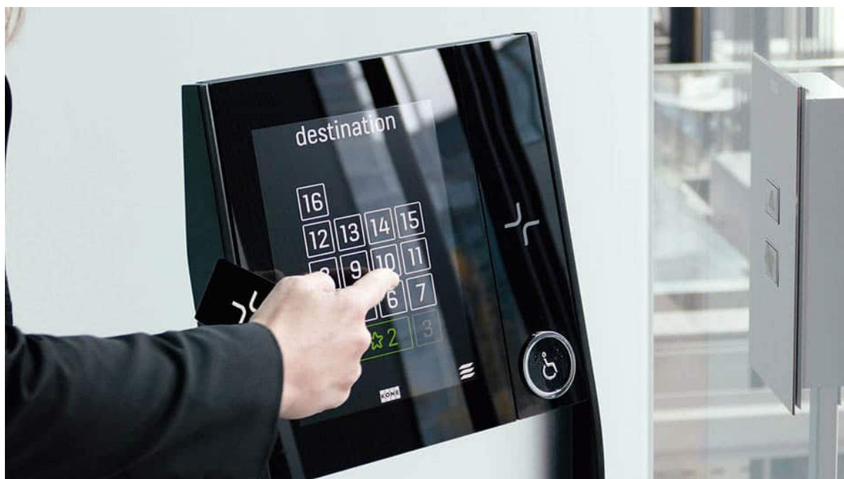
ภาพประกอบที่ 4.2-1: ป้ายควบคุมแบบระบุจุดหมายปลายทาง (Destination Control) บริเวณล็อบบี้ของอาคารสำนักงาน
