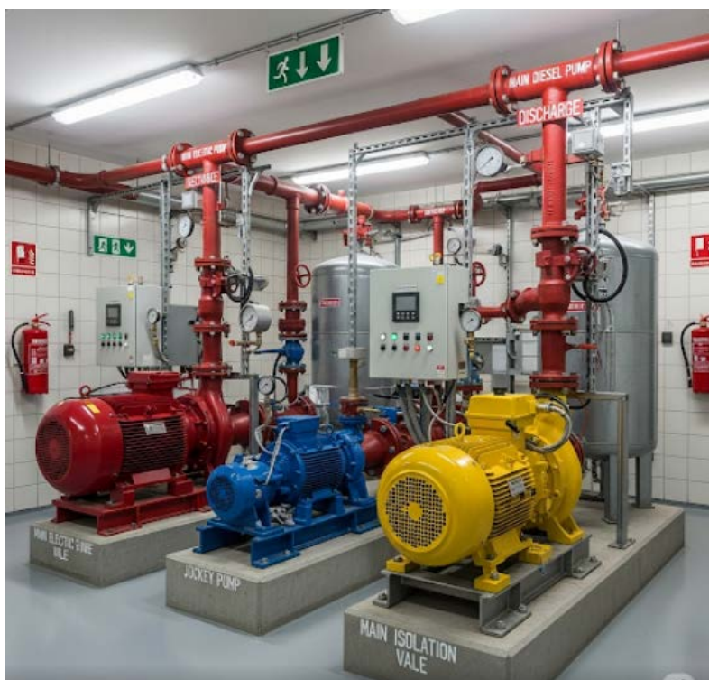
ภาพประกอบที่ 3.2-2: ห้องปั้มน้ำดับเพลิง (Fire Pump Room) แสดงปั้มน้ำดับเพลิงหลัก ปั้มน้ำสำรอง และปั้มน้ำรักษาแรงดัน (Jockey Pump)
