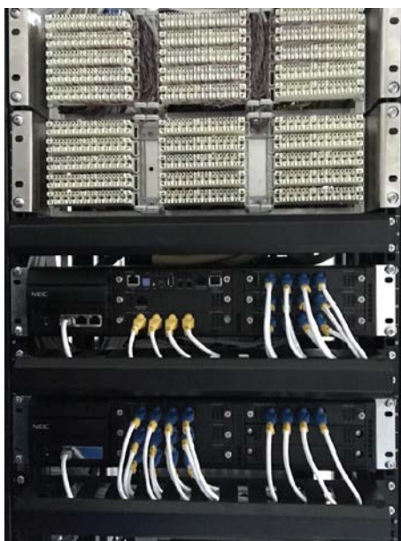
ภาพประกอบที่ 1.2-1: ตู้กระจายสายสัญญาณหลัก (MDF) และตู้กระจายสายสัญญาณย่อย (IDF) ภายในอาคาร
