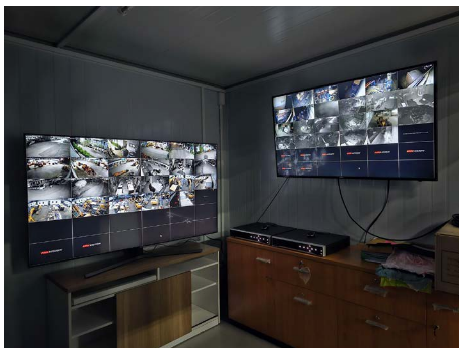
ภาพประกอบที่ 1.2-3: ห้องควบคุมระบบรักษาความปลอดภัยแสดงจอภาพจากกล้องวงจรปิดหลายจุดของ
