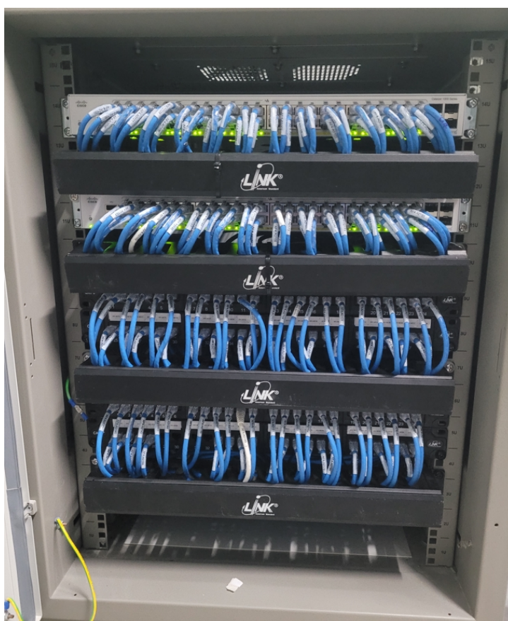
ภาพประกอบที่ 1.2-2: ตู้ Rack เครือข่ายคอมพิวเตอร์และการเดินสาย UTP ในรางเดินสายสัญญาณ
